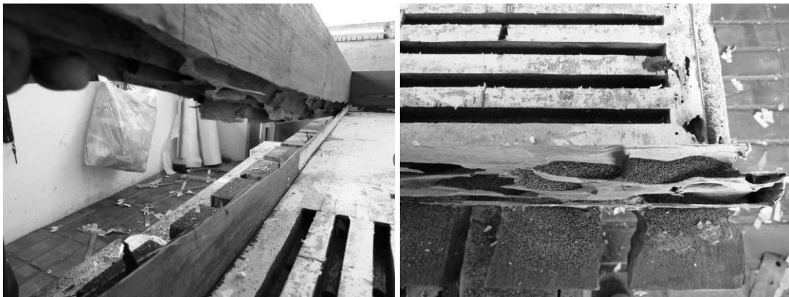
Fig. 8 – Grave infestação de xilófagos sobre os costados do someiro do órgão.
