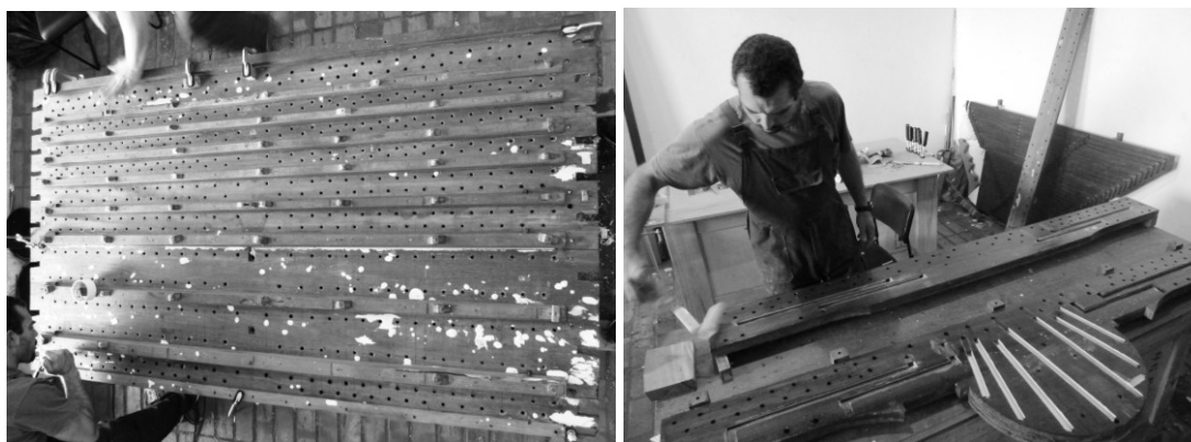
Fig. 13 – Reparação dos ataques pontuais de xilófonos sobre as tapas do someiro com cola orgânica quente e blanco de España e restauro do pranchão acanalado de alimentação dos tubos de fachada do órgão.
